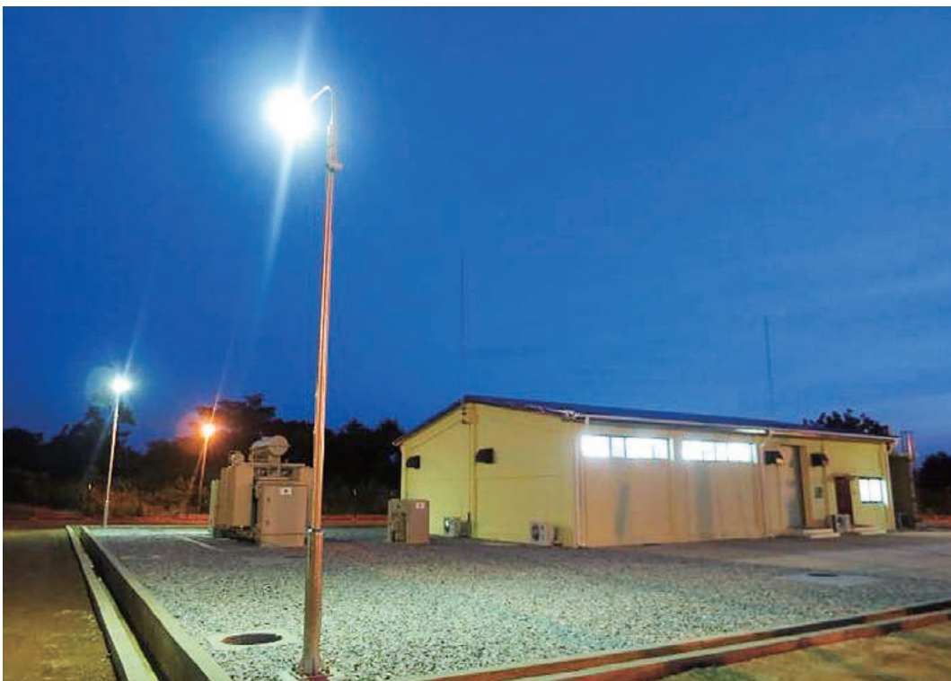
スニヤニ地区一次変電所の完成風景
