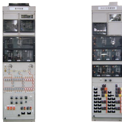
【第三世代デジタル型配電用変電所配電盤】
