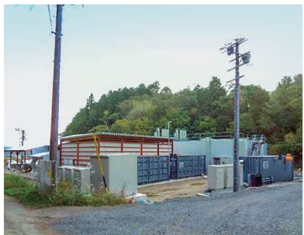
図4 完成したバイオガス発電プラント
