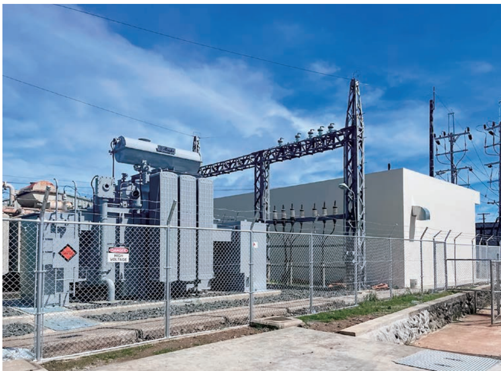
マラカル変電所ー全景および負荷時タップ切換変圧器
