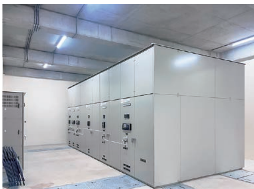
34.5 kV 開閉装置
