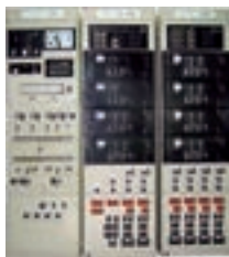
デジタル式監視制御装置
