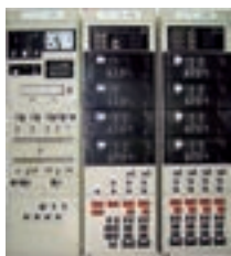
デジタル式監視制御装置
