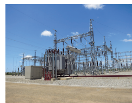
ナミアロ変電所の完成風景
