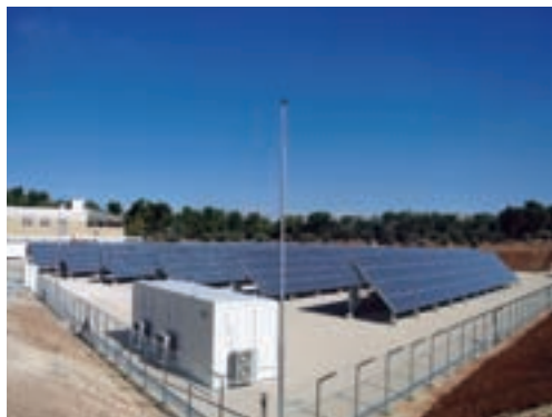
ヨルダンの首都アンマンに設置した280キロワット太陽光発電設備
