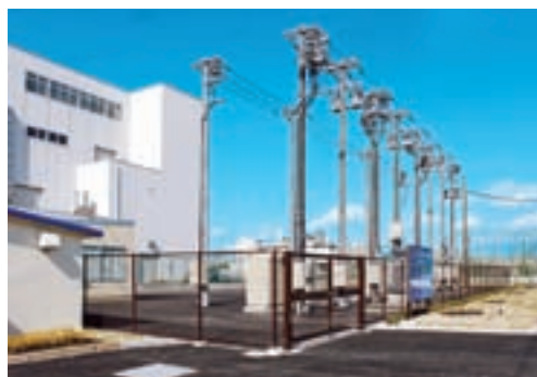
次世代配電機器実証試験設備「スマートステーション」
