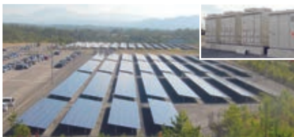
発電所全景とパワーコンディショナ（右上）
