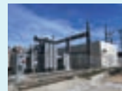
大型変圧器（海外）
