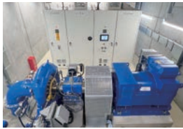
水力発電装置 Hydropower turbine, generator and control panels
