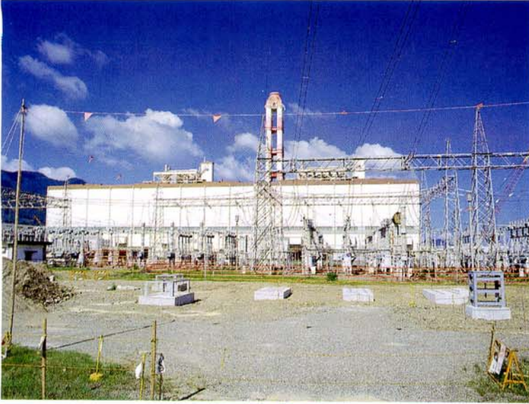
⊖中部電力㈱尾鷲三田火力発電所 併設変電所遠景
