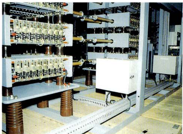
図18 60kV級サイリスタスイッチ
