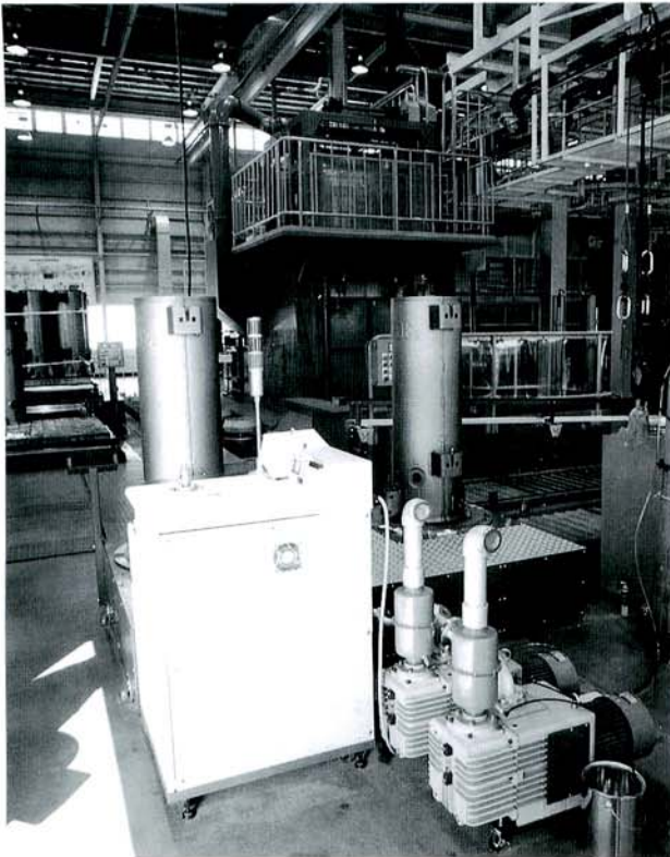
図4/ヘリウムリークテスト装置 Fig. 4/Leakage detector by helium gas
