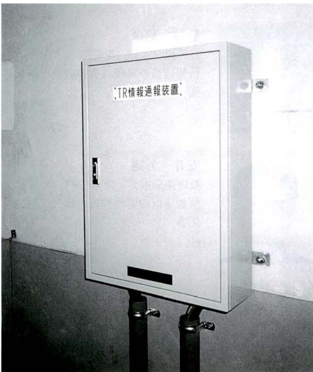
図 7 / 変圧器情報通報装置の設置状態 Fig.7/ Setting state of transformer information message unit
