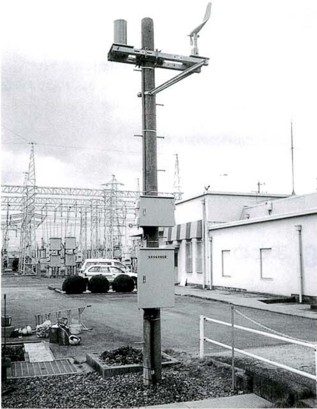
図 6 / 気象情報通報装置の設置状態 Fig.6/ Setting state of weather information message unit
