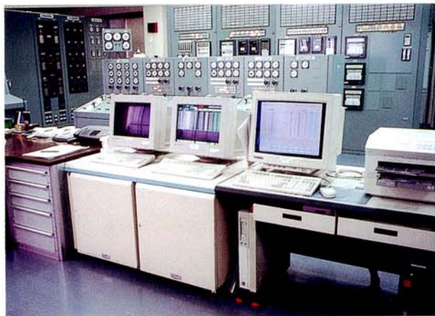
◀ 宮古第二発電所 中央制御室
