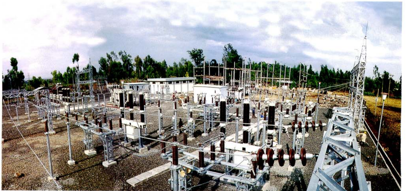
エチオピア アカキ変電所全景
