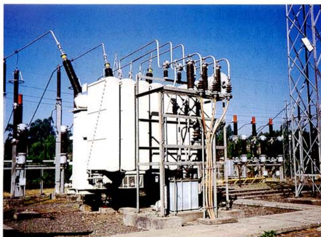
■ アディスノース変電所の主要変圧器
