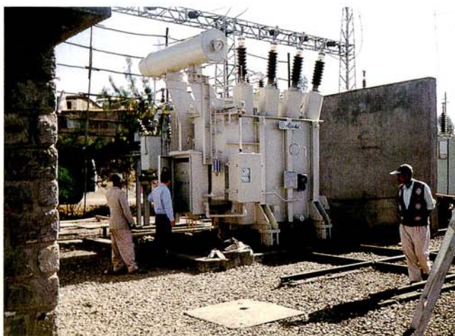
■ アディスウエスト変電所の主要変圧器
