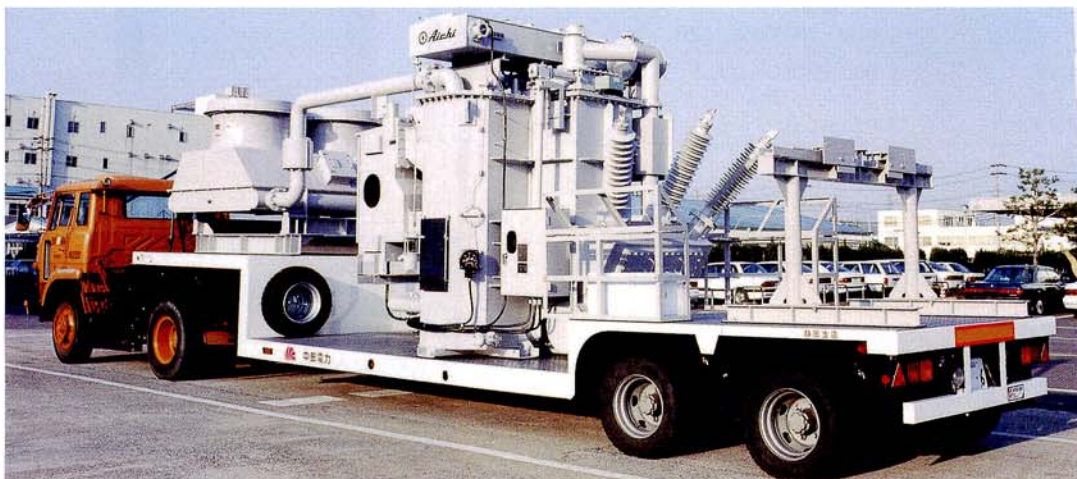
■ トレーラー積載時の移動用変圧器
