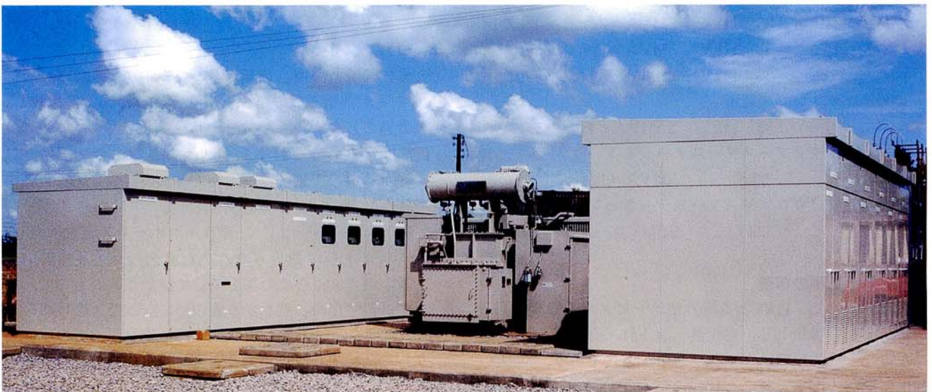
■ カユンガ変電所(主変と高低圧キュービクル)
