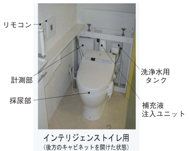
図2 新型尿糖検査機のトイレ設置例
