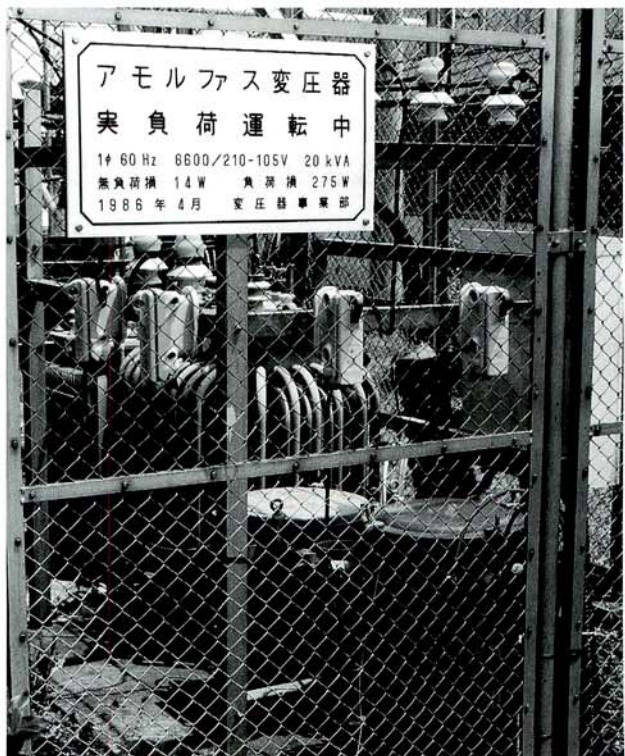
図9 / 実負荷運転状況
