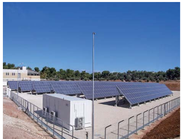
図3 太陽光発電設備全景
