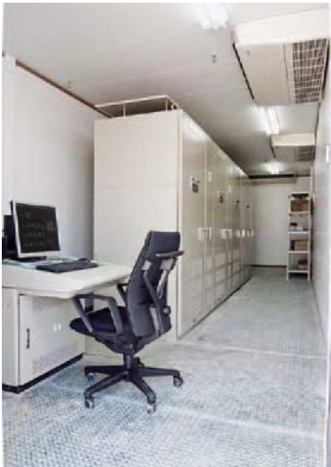
図4 パワーコンディショナ収納ハウスの内部
