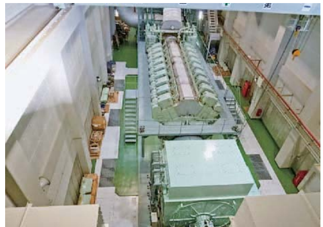
図3 機関室風景 手前から発電機、エンジン
