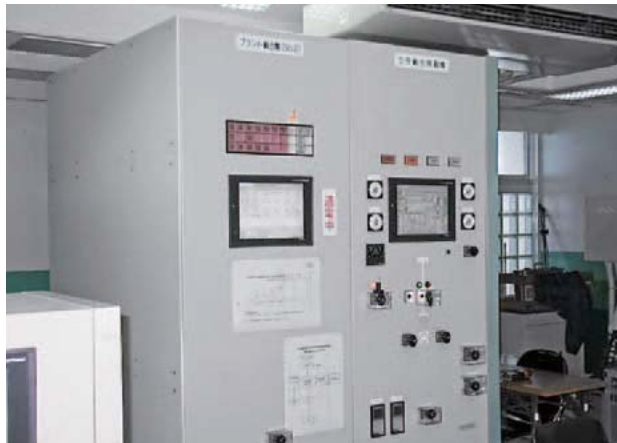
図4 左から プラント総合盤 (No.2)、5号総合制御盤
