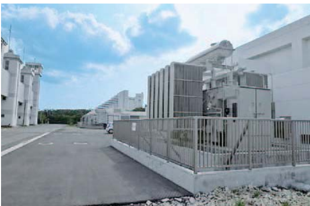
図2 5号機昇圧変圧器 6.6/22kV 23MVA
