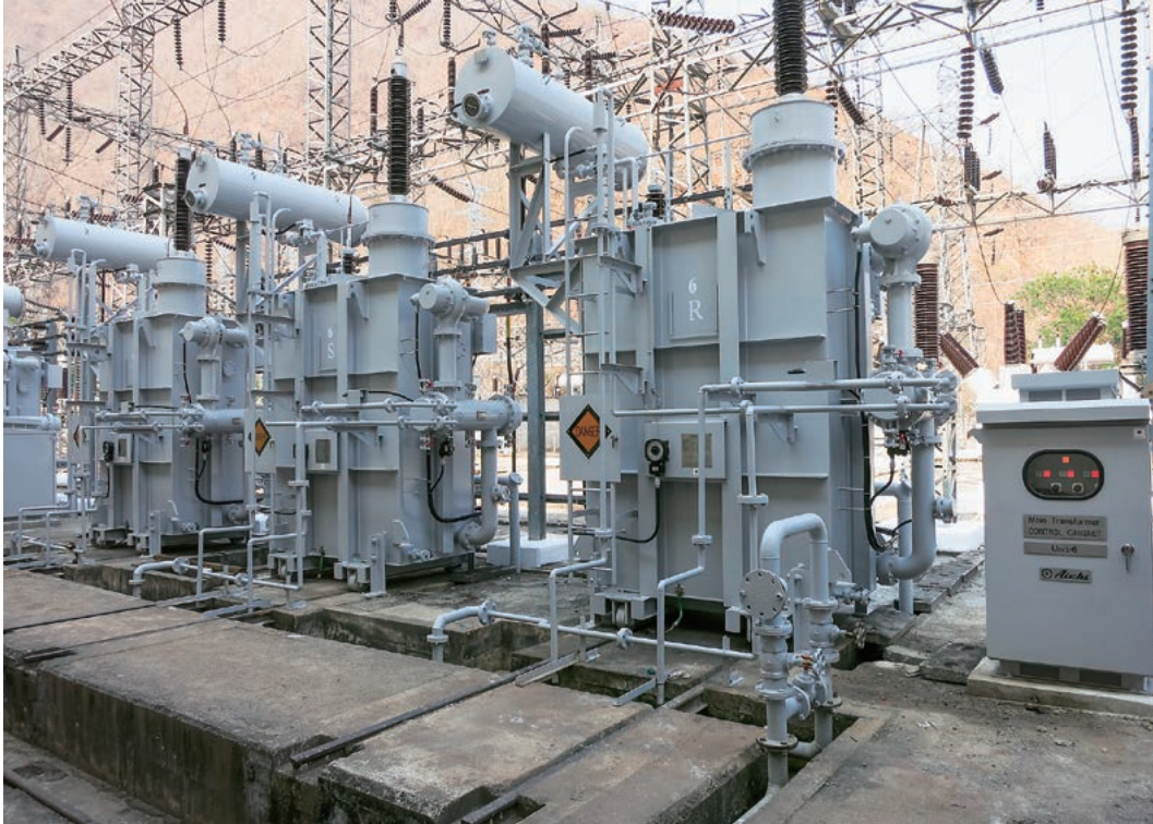
11/132 kV 25 MVA 主変圧器
