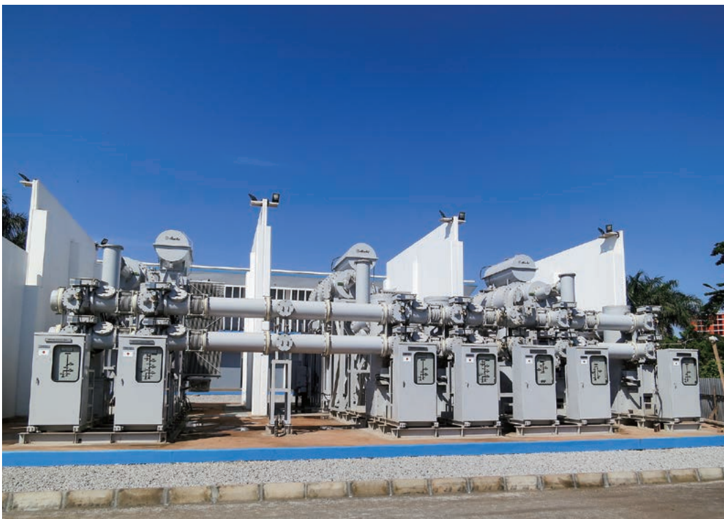
変電所の完成風景
