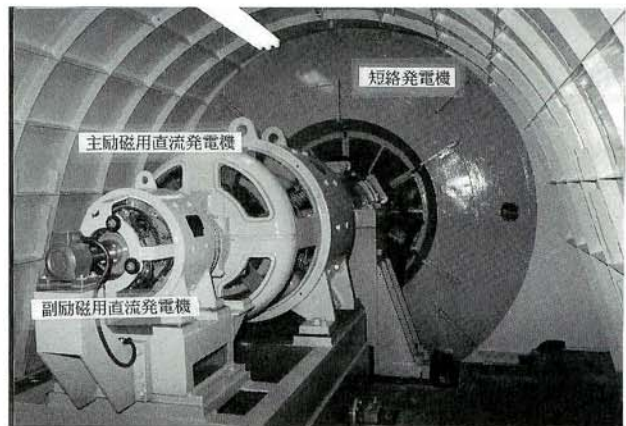
図2 / 発電機棟内部(短絡発電機、励磁用直流発電機) Fig. 2/Short-circuit generator and DG generator
