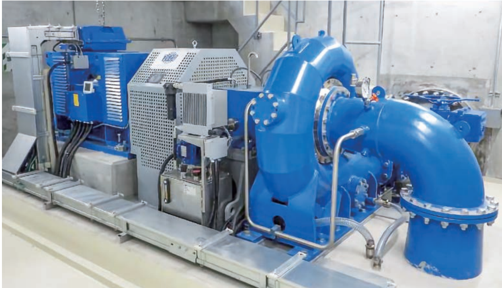
水車発電機の外観
