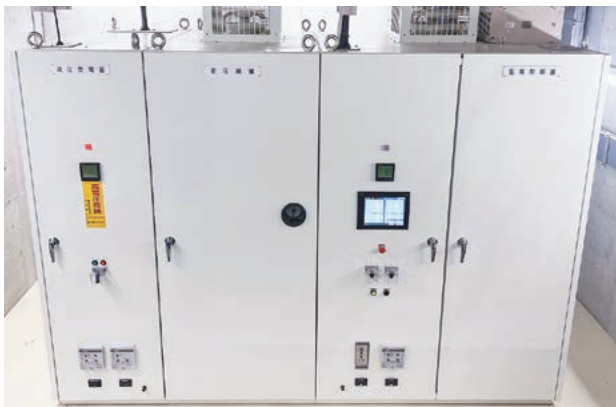
図3 系統連系盤の外観
