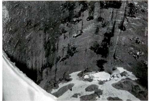
一般ボイラ (電気防食していないタイプ)
