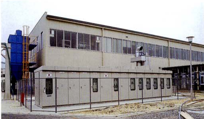
● 工場やビル等で活躍する配電盤類
